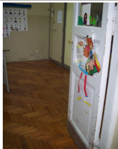
Incumplimiento Ley N.º 962 y CRAE. Pisos de madera. Apertura de puerta hacia interior.
