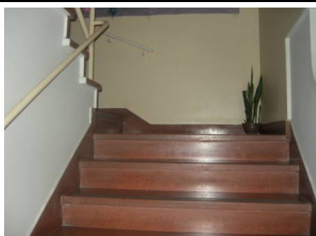
Incumplimiento Ley N.º 962. Escaleras.
