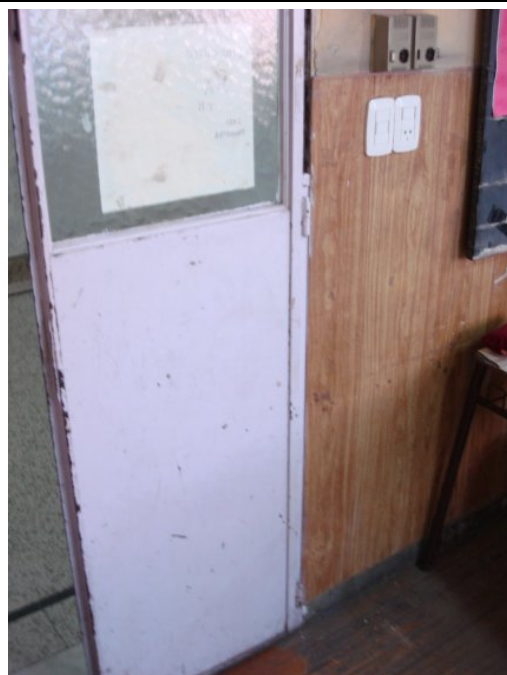
Incumplimiento Ley N.º 962 y CRAE. Pisos de madera. Apertura de puerta hacia interior.
