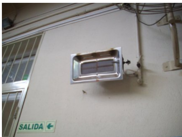
Incumplimiento de calefacción reglamentaria.
