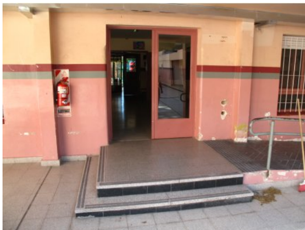
Incumplimiento Ley N.º 962. Escaleras y rampas.
