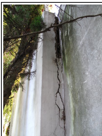
Fisuras en muro medianero.
