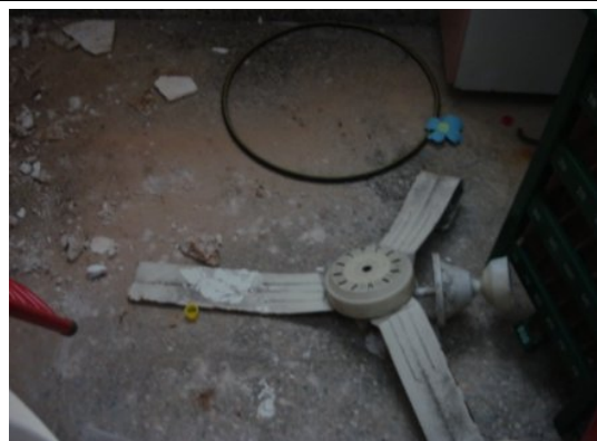
Desprendimientos de cielorraso por humedad de cubierta.
