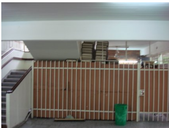
Bajo escalera con material inflamable.
