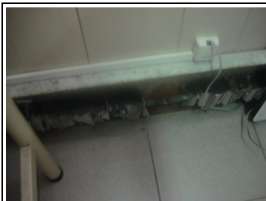
Calefacción en desuso sin protecciones.
